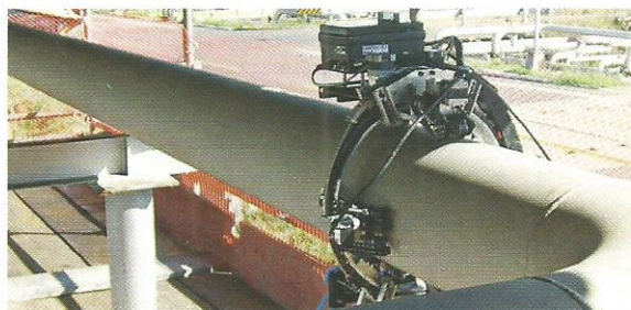
O robô de inspeção em dutos foi o primeiro a ser desenvolvido pelos Engenheiros Miguel e Giovanni, inaugurando um trabalho que visa garantir maior segurança aos trabalhadores envolvidos em atividades de risco e aumentar a eficiência dos procedimentos
